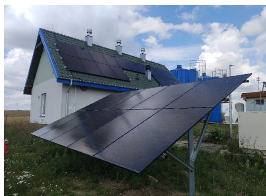
Instalacja fotowoltaiczna SUW w Kurzeszynie
